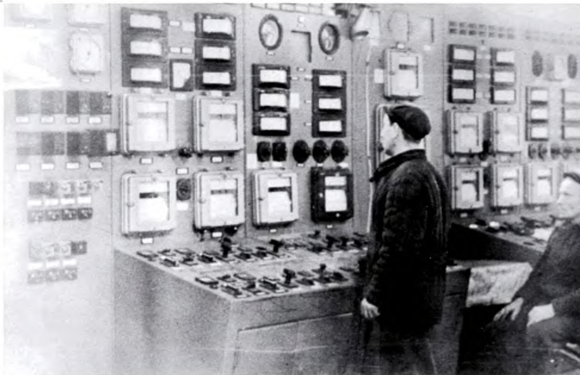
Щит управления котлами горэлектростанции
