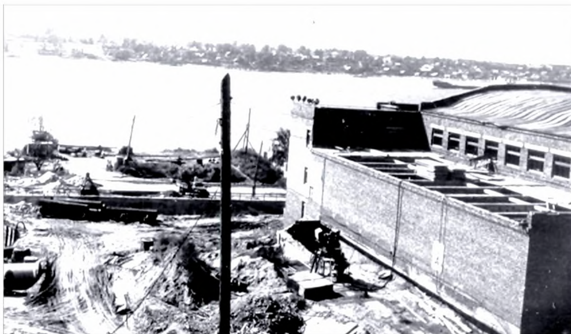
Строительство очистных сооружений, водопровода на улице 1 Мая. Слева монтаж опускаемого колодца станции 1-го подъема
