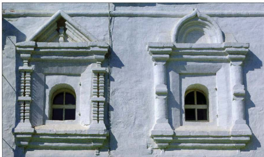
Каждая деталь архитектурного убранства восстановлена с любовной точностью. А могло случиться так, что восстанавливать было бы нечего. На фото: наличники Наместничьего корпуса.
